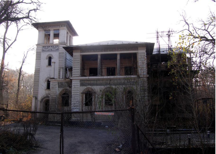
Foto Příklad neudržovaného objektu velké kulturní hodnoty, stav hrozí zánikem - č.p. 276 Liboc. Novorenesanční vila čistých forem, konec 19. století
