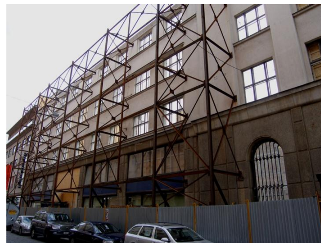
Nepříznivé demolice dispozic objektů za neporušenou fasádou – jev zvaný fasádismus, narušuje hodnoty PPR, je přímo v rozporu s posláním památkové péče a statutem památky UNESCO – objekt ČSOB na rohu Příkop a Panské ulice
